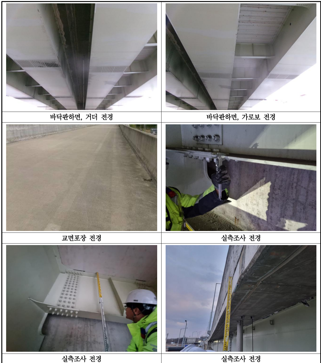
【사진 1.2.2】 상부구조 현황
